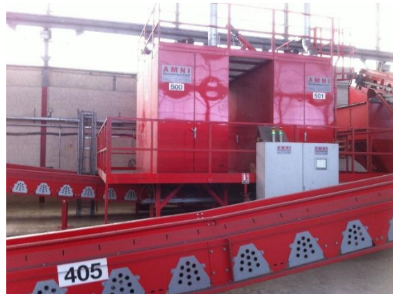
Figure 30 : Séparateurs électrostatiques en parallèle
