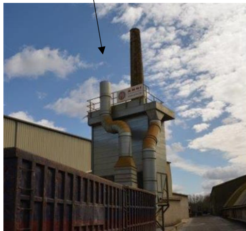
Figure 35 : Unité de traitement des poussières.
