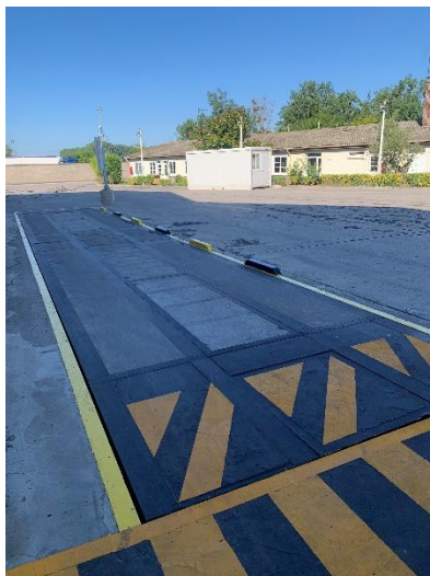
Figure 6 : pont bascule en fosse
